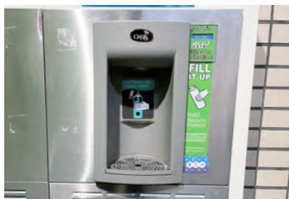
1 階ロビー給水機
